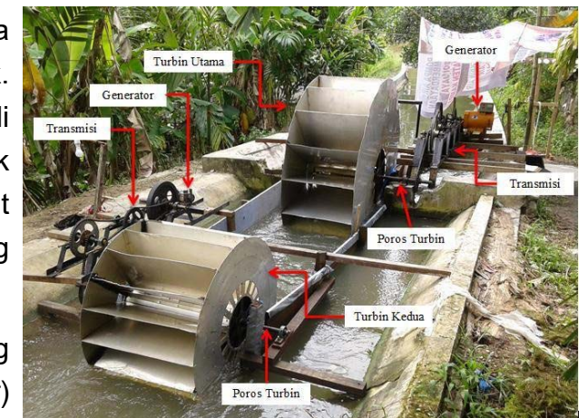
Gambar 29. Pembangkit Listrik Tenaga Air Sumber: https://docplayer.info/61310837-Kaji-eksperimental-turbin-air
